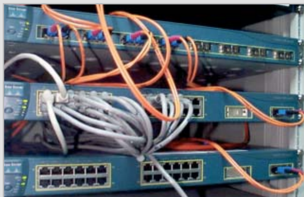
Lo standard 1000BaseT usa le stesse frequenze di lavoro di Fast Ethernet ed è quindi retrocompatibile con i cablaggi del vecchio standard
